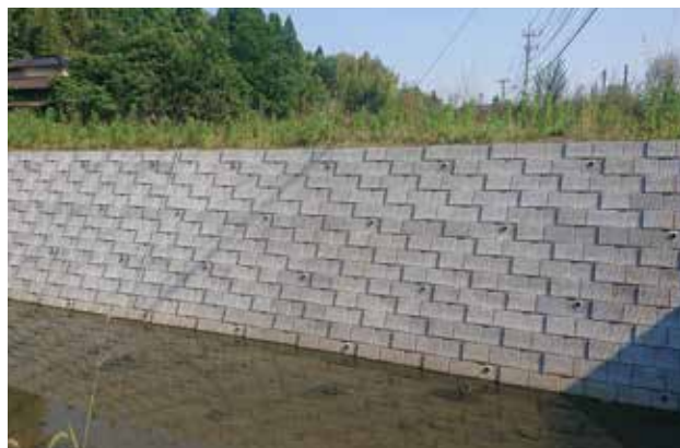
関川 災害復旧 (熊本県)
