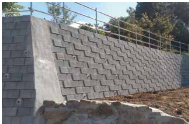
農地災害復旧 (熊本県)
