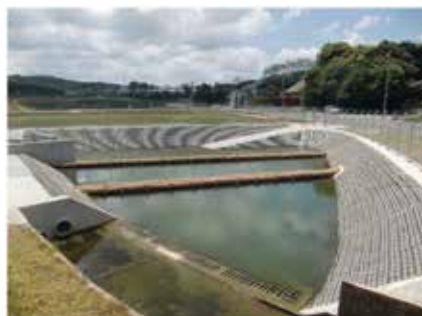
調整池に設置した状況
